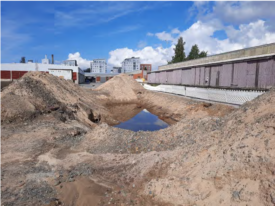
Kuva 2. Vedellä täyttynyt kaivanto (3.8.2020).
