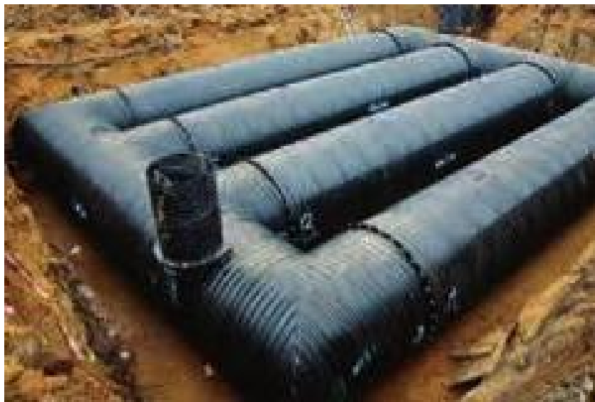
Kuva 3. Hulevesisäiliö. Lähde: ViaCon Oy.
