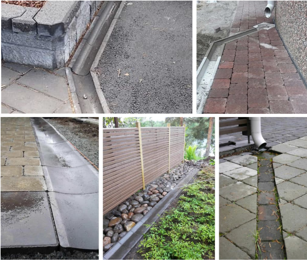
Kuva 23 Pinnoitetuilta piha-alueilta ja katoilta tulevia vesiä kuljettavia kouruja. (Kuvat vasemmalta ylhäältä: Maisemabetoni, Turun reunakivi, alarivin kuvat: Pihakivi.com)
