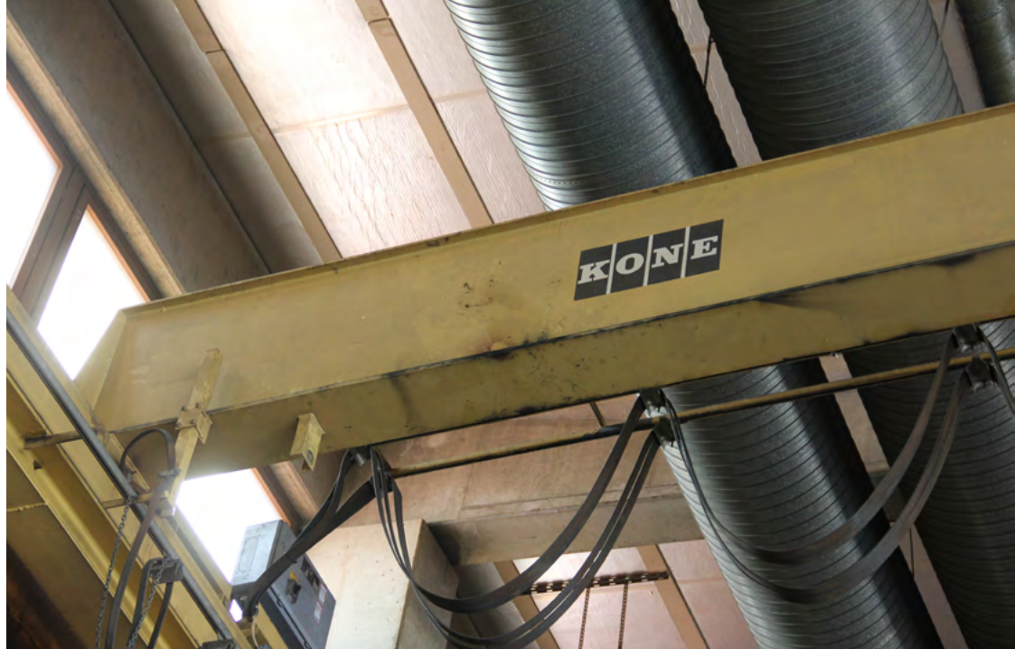
150. Korjaamon käytössä on päästä päähän kulkeva siltanosturi.
